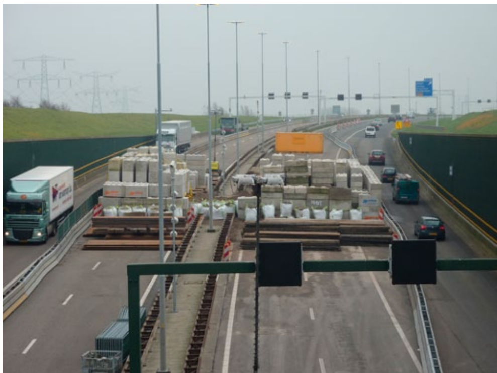
Reparatie aan de Vlaketunnel, A58 nadat een deel van de fundering was bezweken
