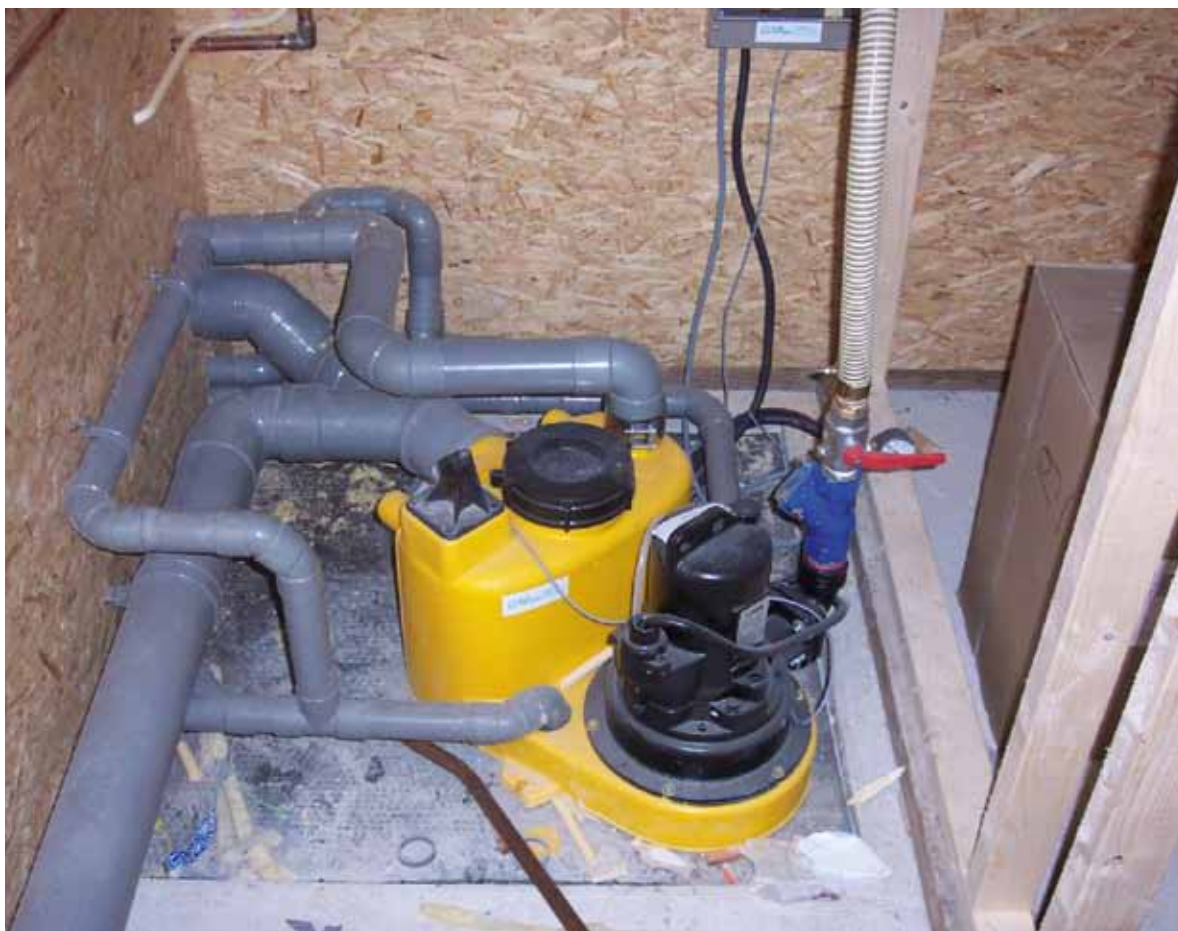
Foto boven: Rioolpomp in drijvende woning. Foto: ABC Arkenbouw
